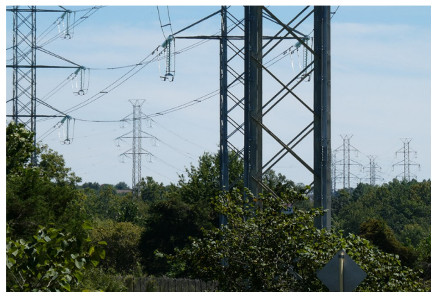
Líneas de transmisión eléctrica a lo largo del corredor W&OD en Ashburn, Virginia, que transportan electricidad hacia una de las mayores concentraciones del mundo de centros de datos en la nube y de IA. Fuente: Foto de Kit Case (Flickr).
