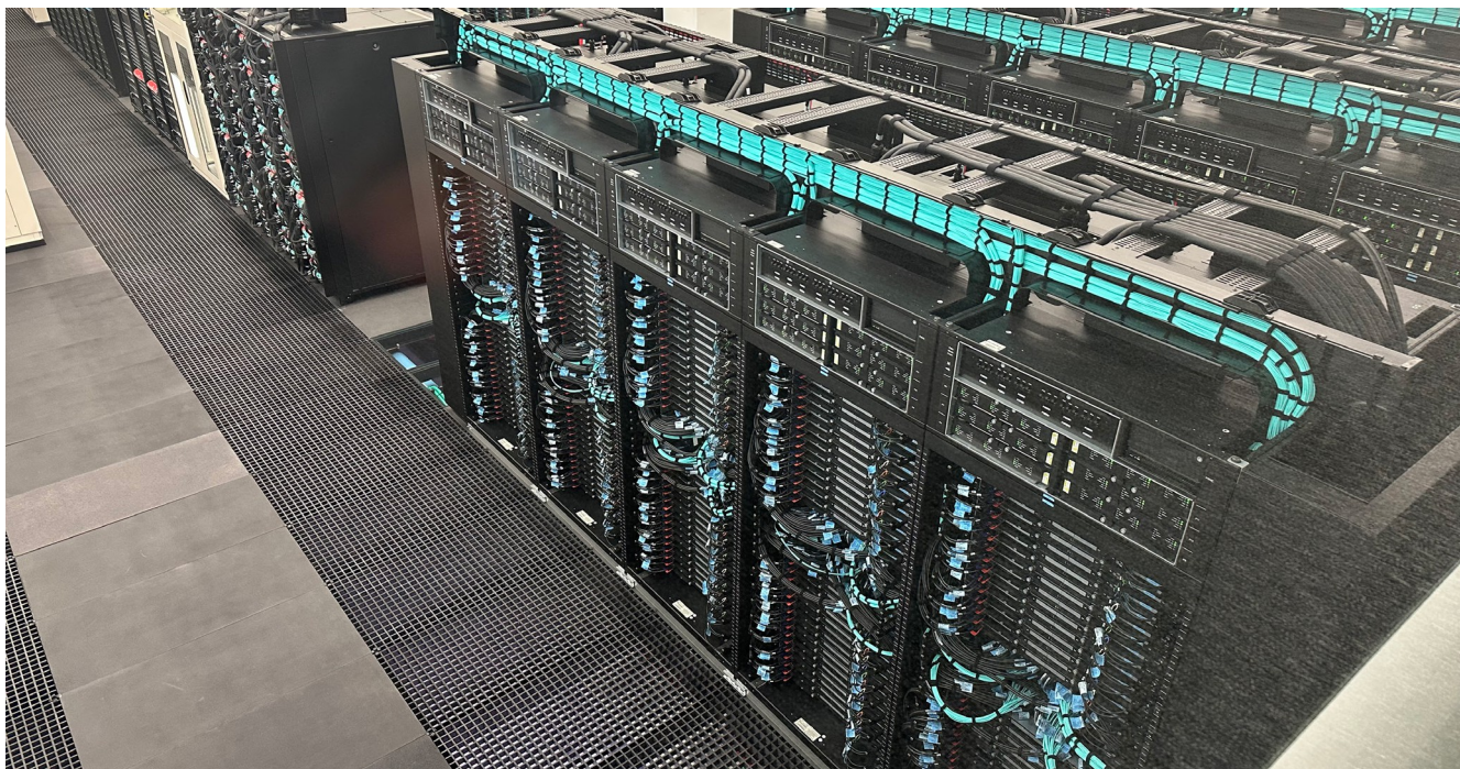
Vista interior de MareNostrum 5, un superordenador insignia europeo, en el interior de la histórica capilla del Centro de Supercomputación de Barcelona, en España. El sistema se encuentra entre las instalaciones de computación de alto rendimiento más potentes de Europa, con una potencia de cálculo de unos 314 petaflops. Actualmente se está actualizando en el marco de la iniciativa «BSC AI Factory» de la Empresa Común EuroHPC para ampliar la capacidad de Europa en materia de inteligencia artificial, con GPU de última generación, mayor capacidad de almacenamiento y un sistema de refrigeración energéticamente eficiente que permita el entrenamiento de IA a gran escala y el aprendizaje automático avanzado para startups, investigadores e instituciones públicas de toda Europa. Foto de Steve Jurvetson (Flickr).
