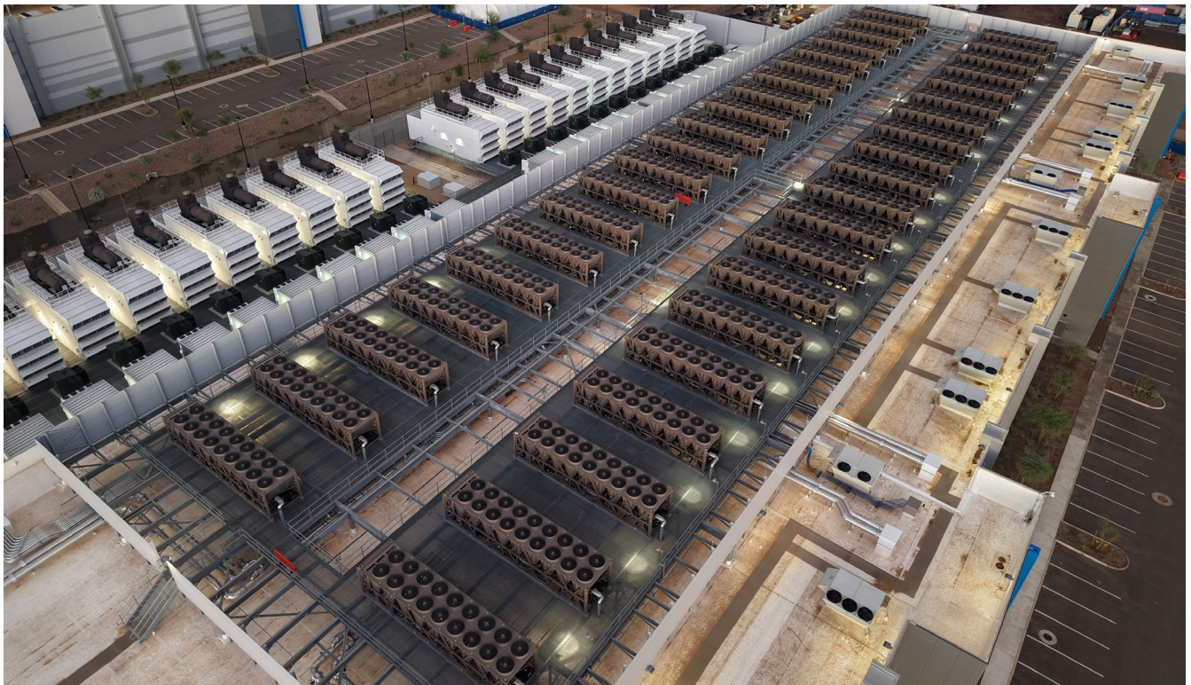
Techo de un centro de datos en el que se aprecian los equipos de refrigeración y los generadores de emergencia. Estos sistemas garantizan el control de la temperatura y la continuidad del suministro eléctrico para las operaciones informáticas de alta densidad, gestionando el calor y proporcionando electricidad in situ durante los cortes de suministro. Foto de Rspark3 (Wikimedia Commons).
