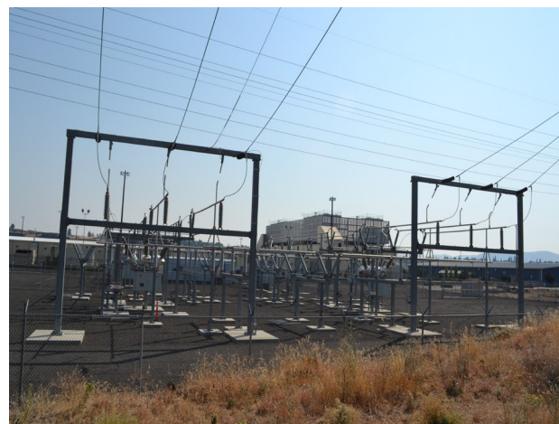
Centro de datos de Google, The Dalles, Oregón, EE. UU. — Las líneas de transmisión de alta tensión alimentan directamente a las subestaciones del recinto, convirtiendo la energía de la red en la electricidad estable y continua necesaria para hacer funcionar miles de servidores. Foto de Visitor7 (Wikimedia Commons).
